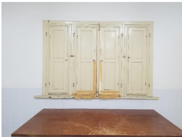
Figura 1 - Fissura no revestimento abaixo da abertura
