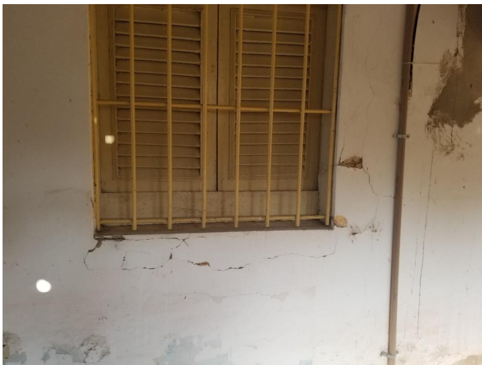
Figura 6 - fissuras abaixo da esquadria
